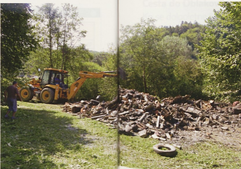
V mrtvici je delavce čakalo neprijetno presenečenje po količini odpadkov.
