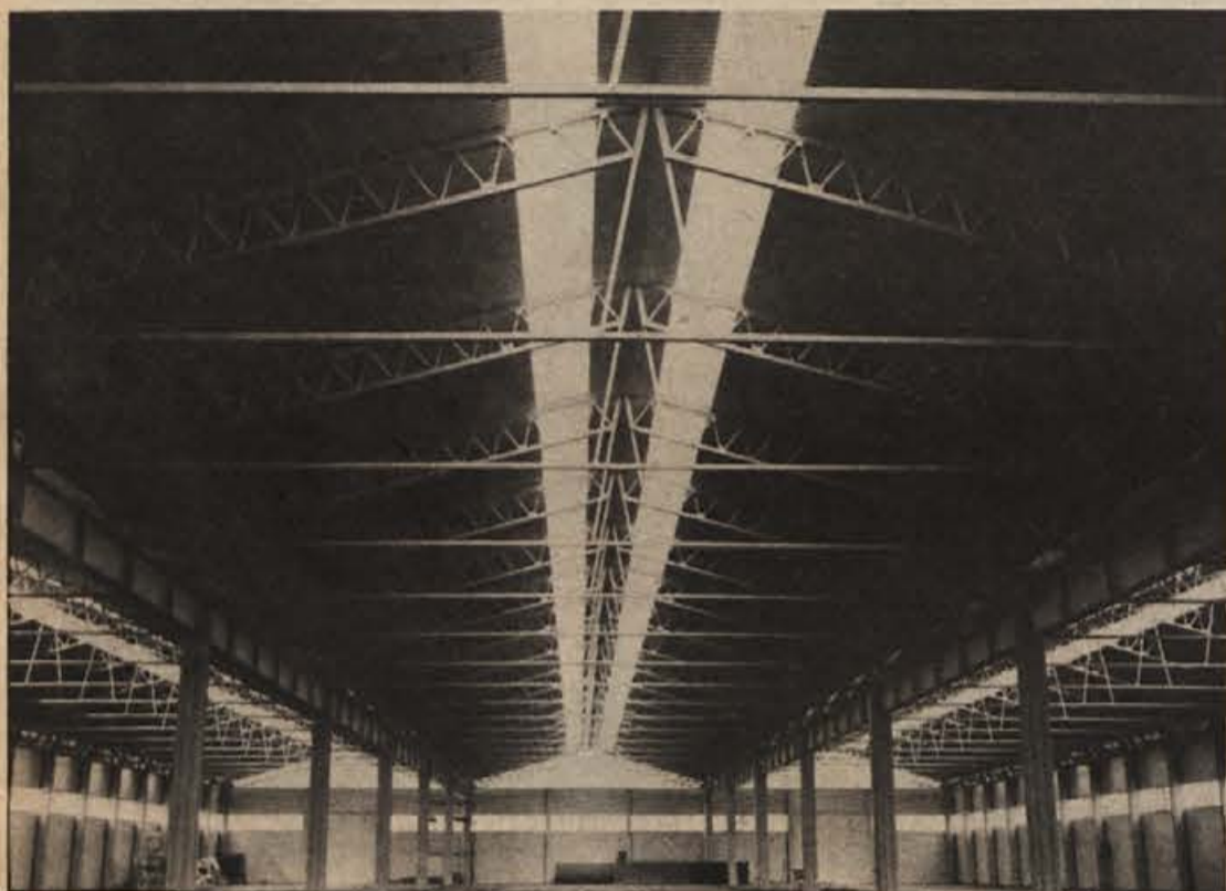
Pogled v notranjost objekta, ki so ga izdelali in postavili trebanjski kovinarji.
