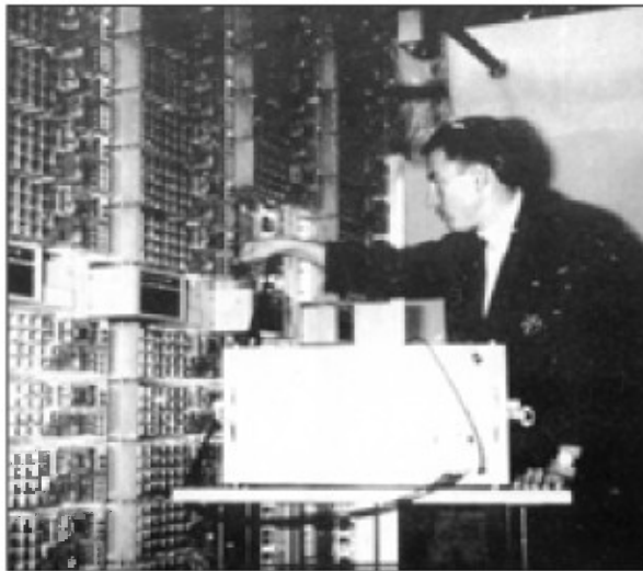
Montaža glavne avtomatske telefonske centrale (Poštar, september 1981)
