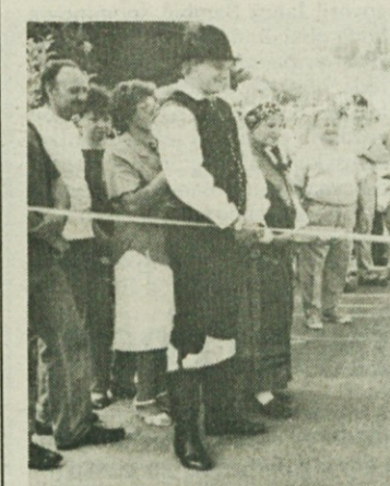
CESTA DVEH OBČIN - Na cesti na Trščini sta trak prerezala predsednik KS Tržišče Marjan Jamšek in predsednik KS M okronog Ivan Vovk, katerima sta pridržala škarje Mitja Sebanc in Cvetka Granda. Otvoritev medobčinske ceste se je udeležila tudi predsednica sevniške občinske skupščine Breda Mijovič, ki so jo domačini sprejeli z vso pozornostjo. (Foto: L. M.)
