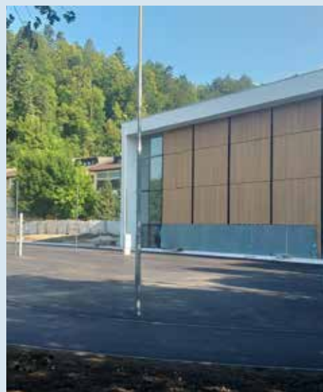
Na zunanjih športnih površinah je asfaltiranje zaključeno, na atletsko stezo se bo položil tartan. Sledi še namestitev zunanje športne opreme (koši, goli, zaščitne ograje) in zunanje ograje, ki bo preprečevala vandalizem v obliki voženj s kolesi in motorji po zunanjih športnih površinah.
