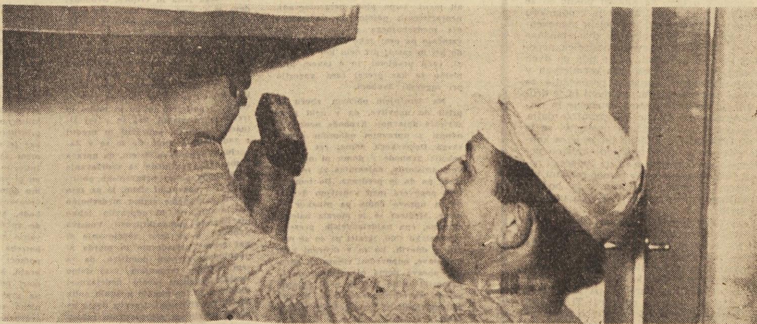
V stolpnici S1 v Savskem naselju v Ljubljani, ki je bila pred kratkim komaj vseljena, so »pozabili« na odvajanje pare, ki nastaja pri kuhi. Zavoljo tega precej trpi vgrajeno kuhinjsko pohištvo. Te dni razkopavajo stene, da bi vgradili ventilacijo za odvod sopare
