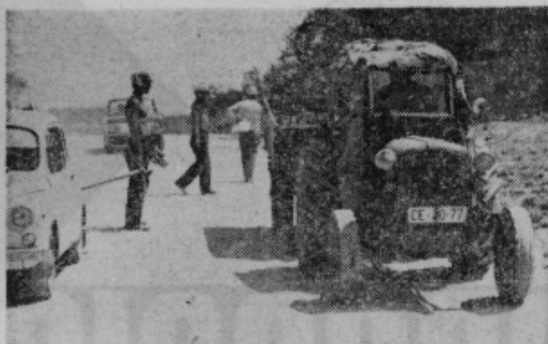
Delavci cestnega podjetja iz Celja so začeli s pripravljalnimi deli na Smehovem klancu, ki je v dolžini 1500 metrov še edini neasfaltiran na relaciji Celje-Rogaška Slatina. V teku so predvsem pripravljalna dela, kot merjenje trase, zakoličevanje, izkopavanje jarkov, širjenje ceste. Foto: tv
