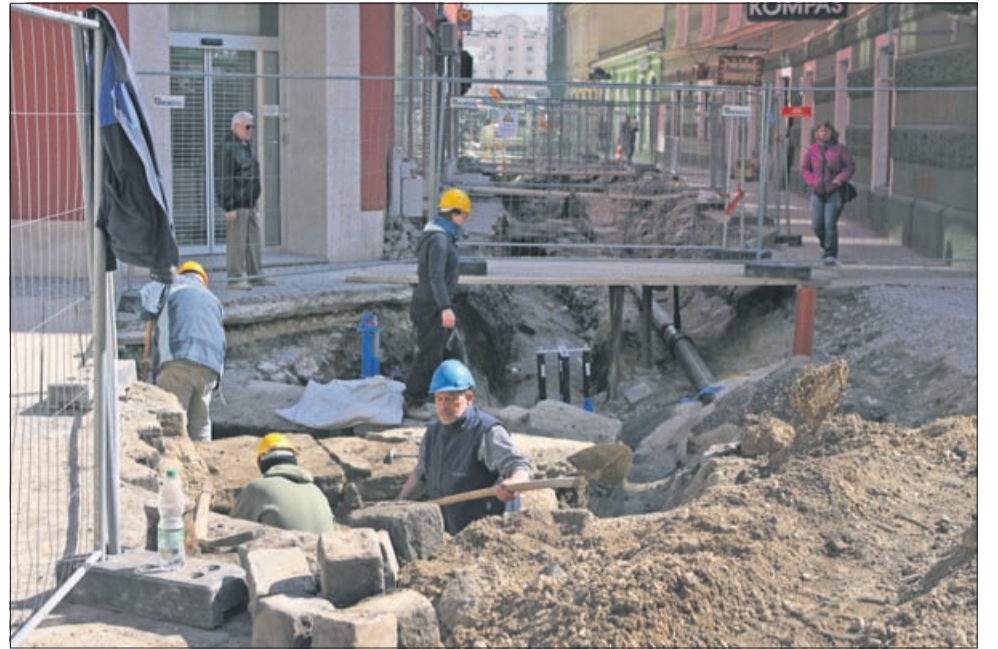
Najbolj razkopano je te dni prav središče Celja, mestna zvezda na stičišču Prešernove in Stanetove ulice ter Glavnega trga.
