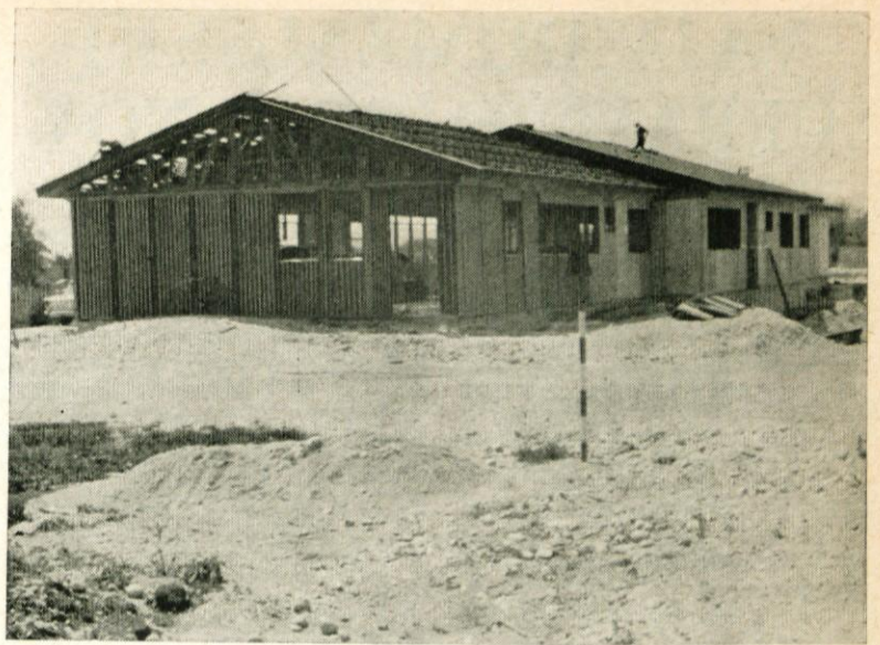
Gradnja montažnega vrtca an Viru, kljub nekaterim zastojem, hitro napreduje. Racionalnost, funkcionalnost in kvaliteto takih objektov je potrdil tudi zadnji obisk predsednika IS SRS tov. Staneta Kavčiča v MARLES-u.
