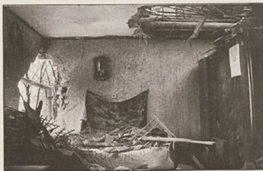
...preluknjala strop in poševno nasprotni zid spodaj...
