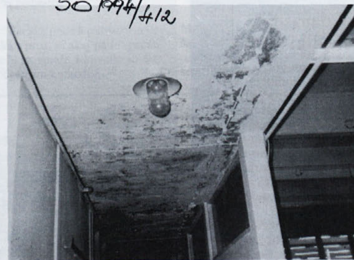
Prvomajsko deževje je načelo streho v Tip-topu in strop je zacvetel...
