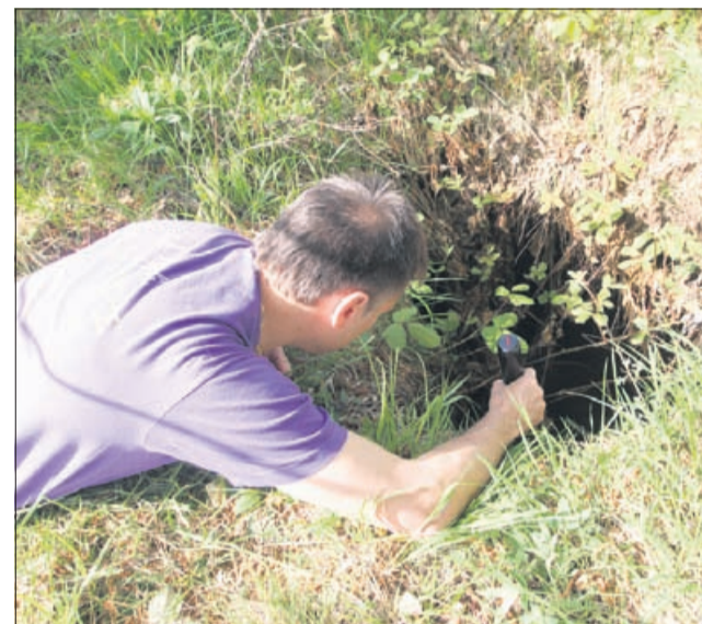
Takole previdno nam je luknjo pokazal Gordan Meze iz Prostovoljnega gasilskega društva Štore. Stopiti na rob ni varno, saj se je zemlja udrla tudi pod robovi.
