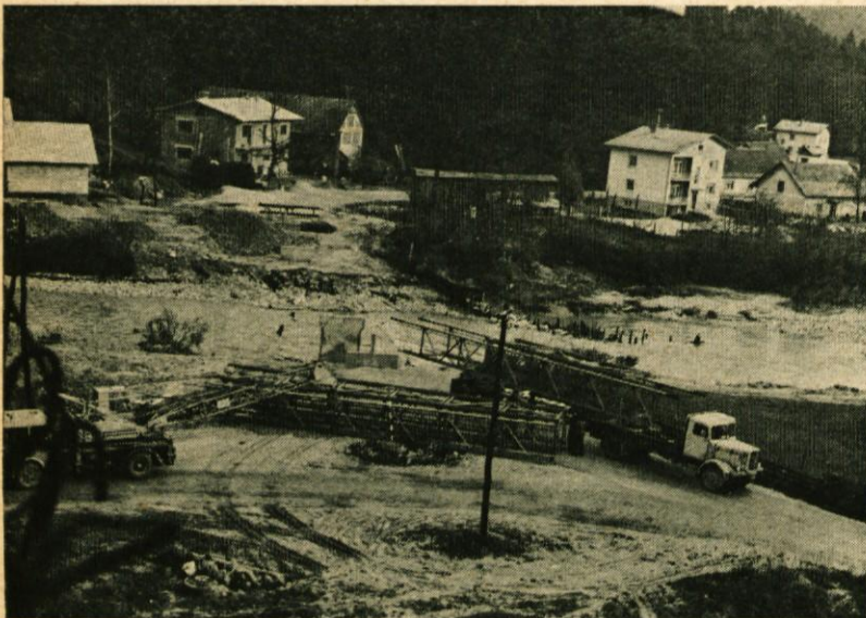
Pred dnevi so začeli dovažati elemente za mostno konstrukcijo, ki bo na koncu Ceste talcev povezovala oba bregova Kamniške Bistrice. Preko te brvi bo prehod za pešce, kolesarje in mopediste tako, da bo odstranjena nevarnost z mostu, ki je bil odprt na koncu Kopaljske ceste
