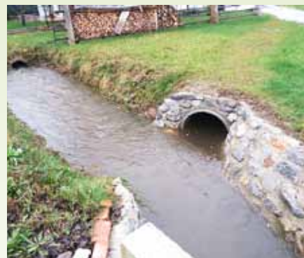
... zastoj vode nekaj 10 metrov nižje, zaradi neprimerne zacevitve jarka
