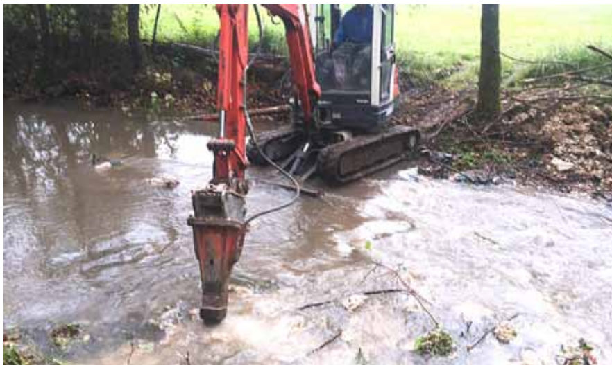
Vidna razlika med vodnim tokom očiščenega in neočiščenega dela struge
