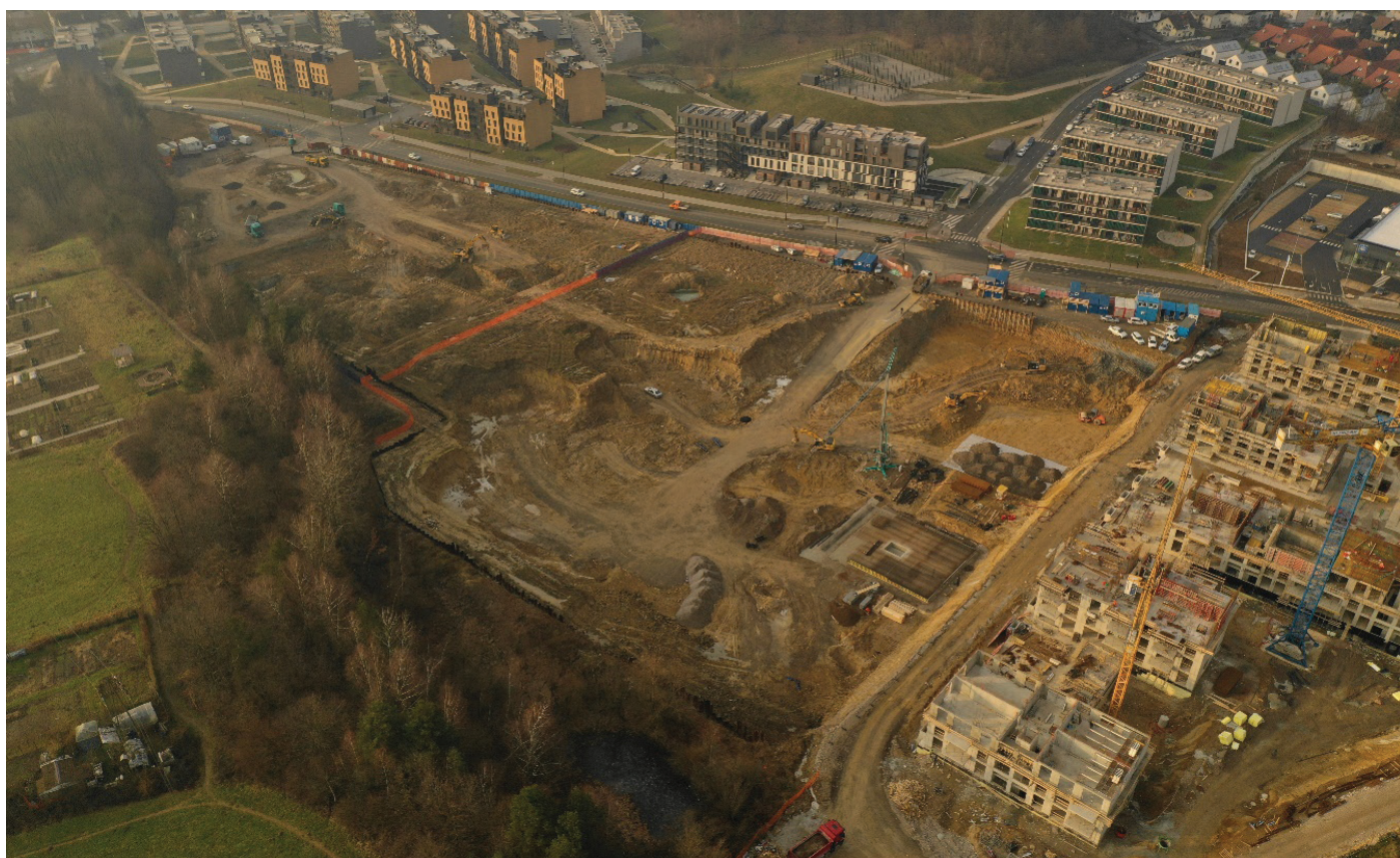
Slika 1. Novo Brdo E2 in E3: Izkop gradbene jame in izvedba zagatnih sten, januar 2020. Foto: Matevž Lavrinc
