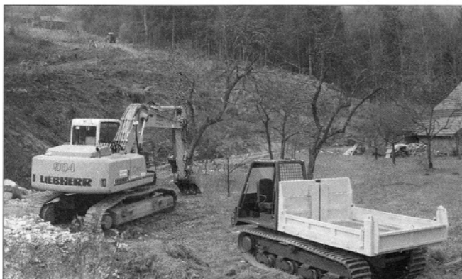
Plaz pri Završnikovih je resno ogrožal objekte in varnost prebivalcev (foto: Benjamin Kanjir)
