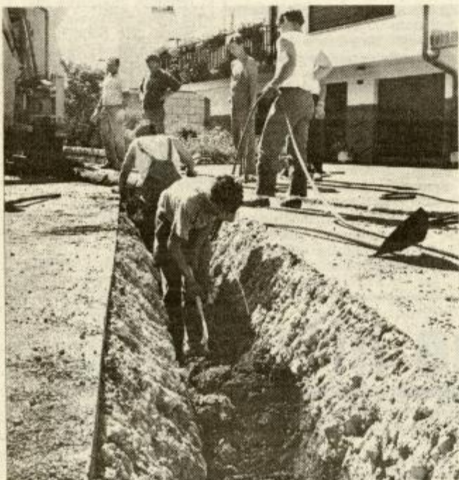
Tako kot kaže posnetek s Hudinje so v teh dneh razkopane številne celjske ulice, kjer urejajo plinsko omrežje.
