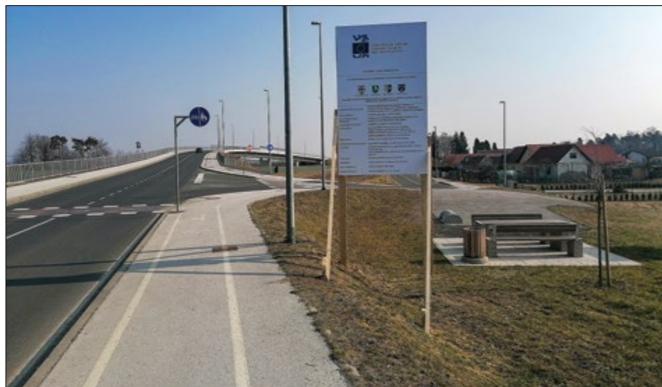
Gradnja kolesarke od Kidričevega proti Hajdini že poteka. Foto: arhiv občinske uprave
