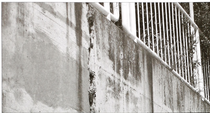
Od zemljišča je začel odstopati še tretji del podpornega zidu. (foto: až)
