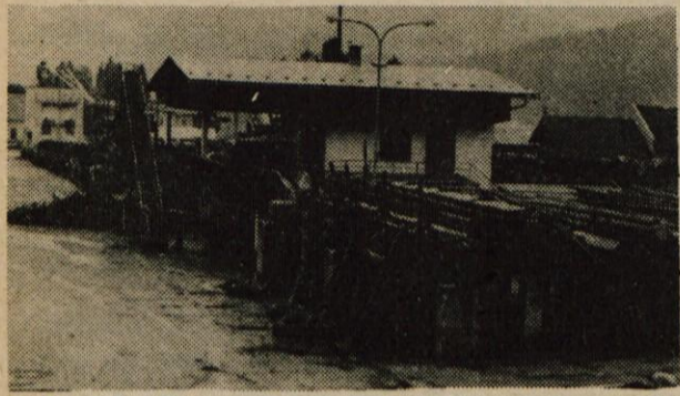
Bohinjska Bistrica - S postavitvijo tekočega traku za lupljenje in razrez hlodovine v temeljni organizaciji združenega dela Tomaž Godec v Bohinjski Bistrici so v podjetju LIP Bled močno povečali proizvodnjo, hkrati pa tudi olajšali delo zaposlenim. Delavci so se zdaj že v glavnem prekvalificirali; tako so s povečano proizvodnjo povečali celotni dohodek in tudi svoje osebne dohodke. - B. B.
