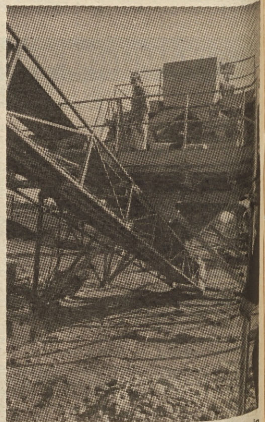
Separacija in betonarna sta povsem mehanizirani in dobro opremljeni s transportnimi trakovi
