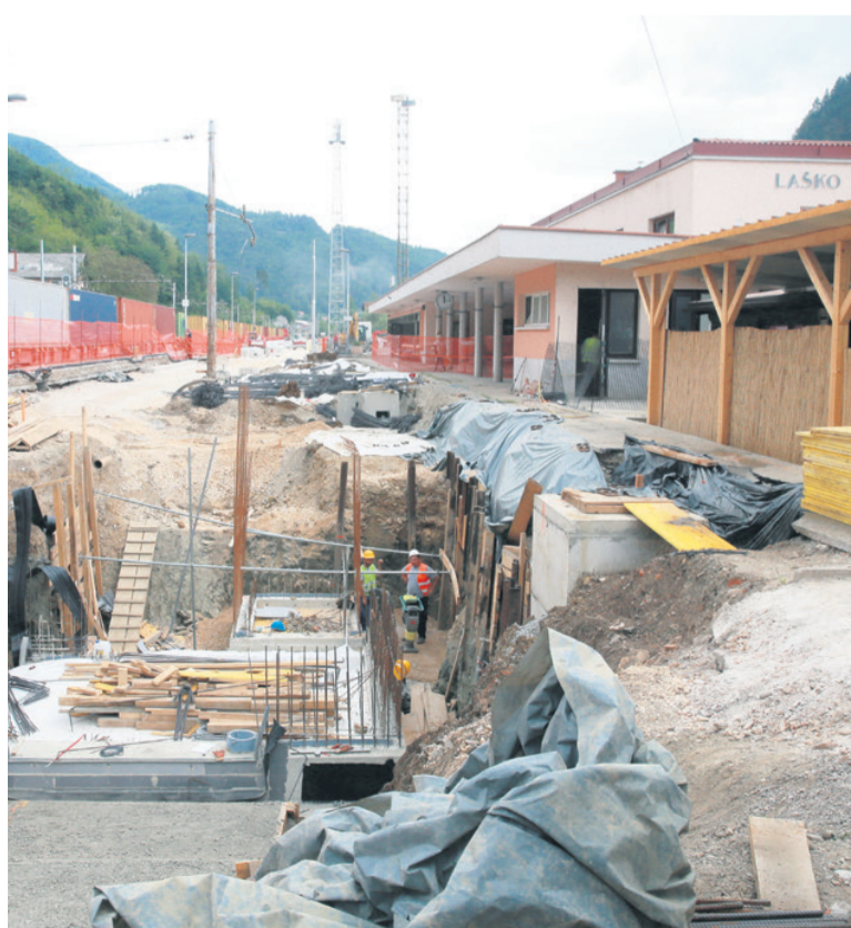
V okviru obnovitvenih del na železniški postaji v Laškem je bil ukinjen nivojski železniški prehod.
