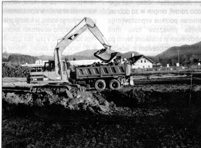
Izkop za začetek gradnje upravne stavbe v Področniku v Mozirju (foto: Benjamin Kanjir)
