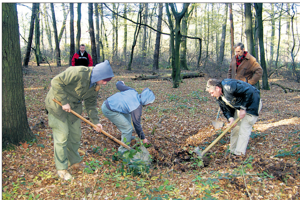
Delavci podjetja Magelan med sondažnimi izkopi zemljišča na območju industrijskega naselja v Kidričevem.
