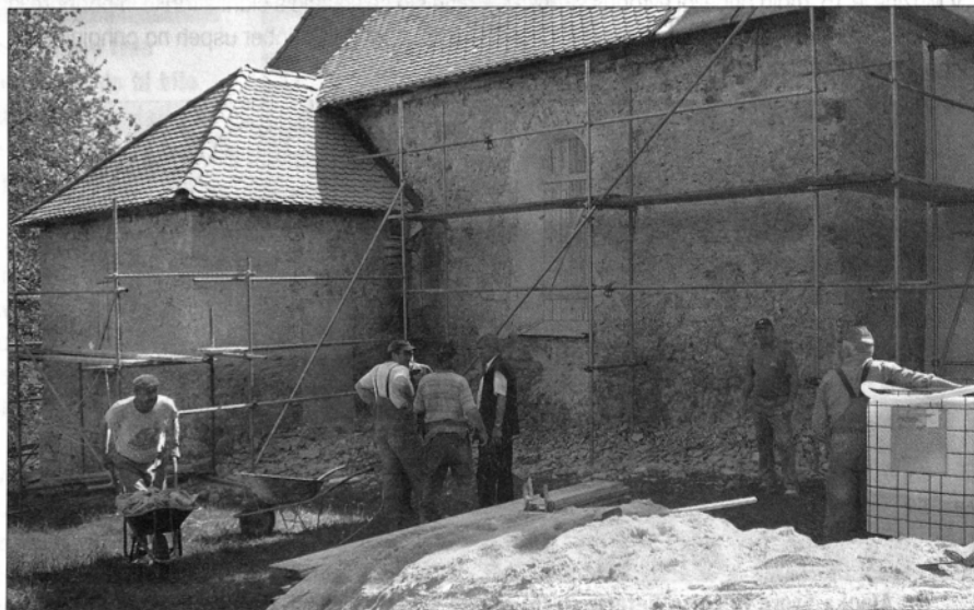
Cerkve je pripravljena na zamenjavo kritine in obnovo fasade (foto: Štefi Sem)
