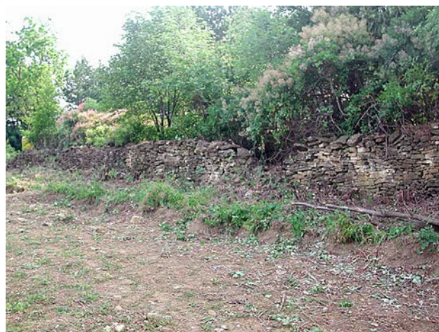
18 Na vrhu 1, zid 1, v ospredju uničen del parc. št. 726/6.
