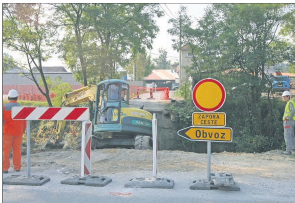
V začetku tedna je »padel« dotrajan most čez Hudinjo v Višnji vasi, nov bo končan novembra.
