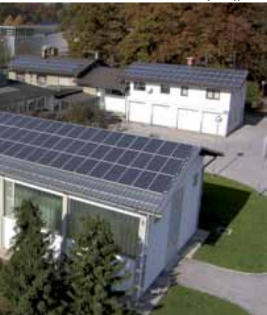
Nova sončna elektrarna na Trati pri Škofji Loki.
