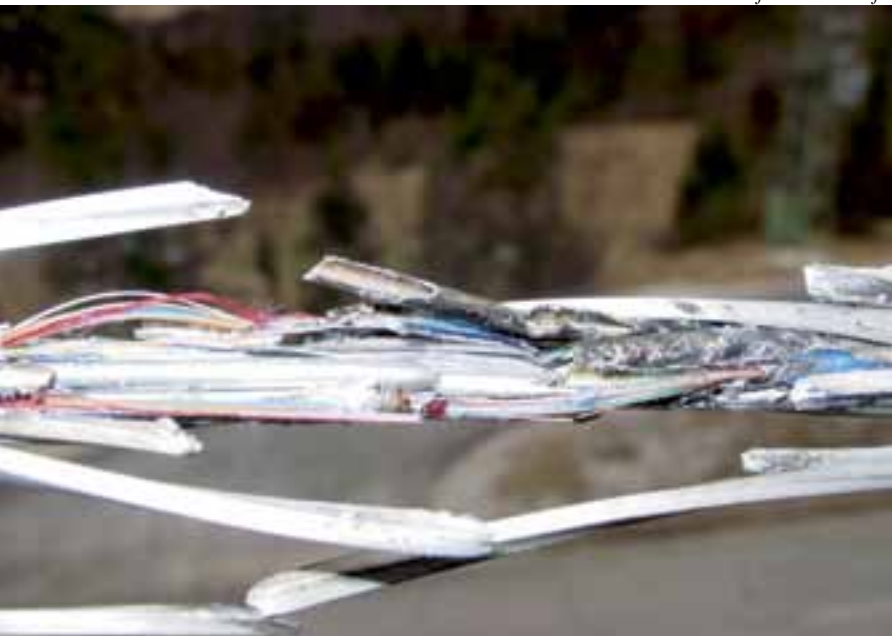
Poškodba OPGW na DV 110 kV Ajdovščina-Idrija.
