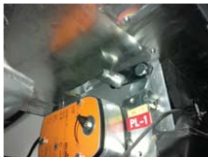
Slika 2: Napačno vgrajena požarna loputa
