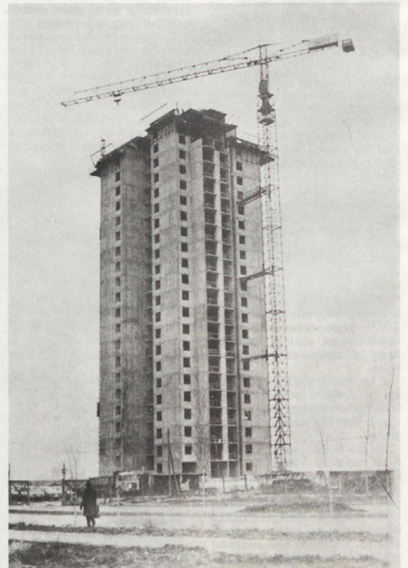
90-stanovanjska stolpnica v Cvetnem naselju v Zagrebu, ki jo je zgradil TOZD Gradbeni sektor Zagreb je pod streho, gradbenega dovoljenja zanjo pa še vedno ni . . .
