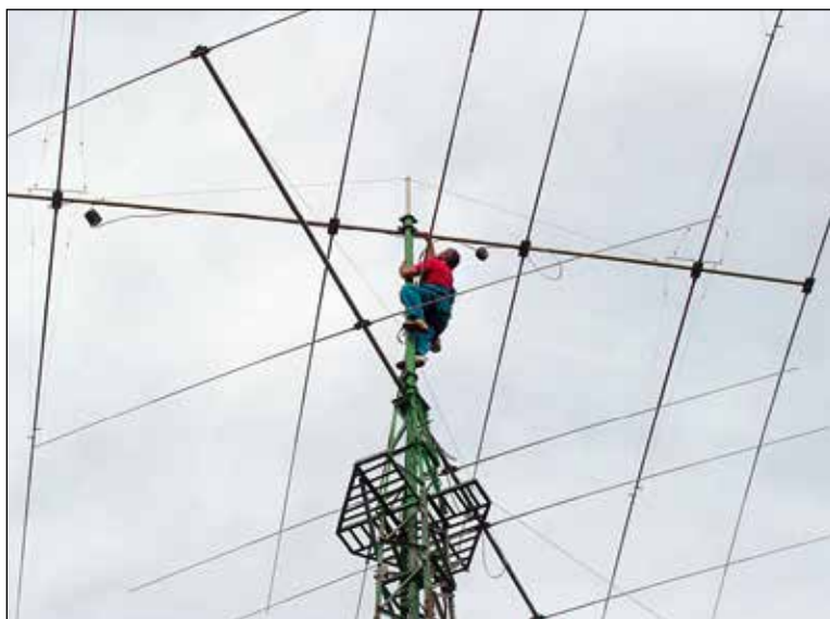
Postavljen antenski sistem v Golici, kjer so pogoji za vzpostavljanje zvez veliko boljši. Na sliki je Dušan Mohorič pri vzdrževanju antene. Foto: arhiv Dušana Mohoriča
