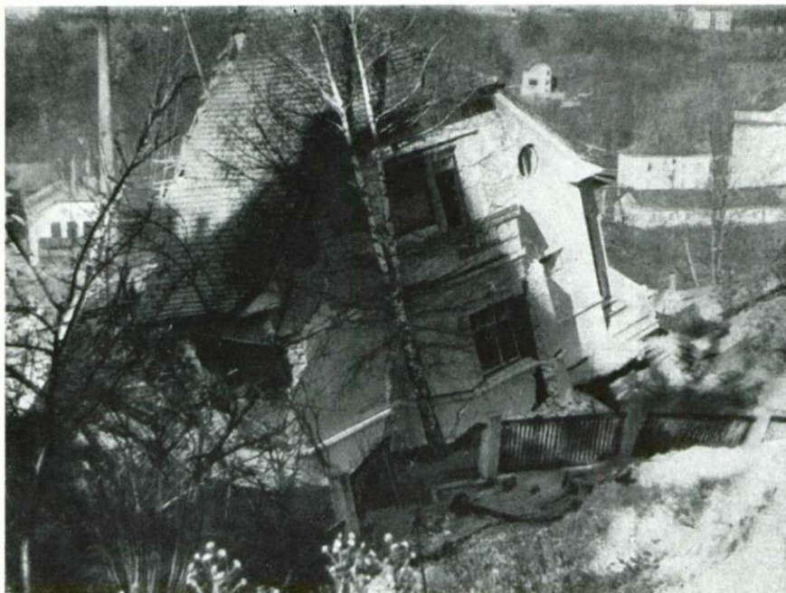
3. sl. Plaz je odnesel hišo, temeljeno na pilotih 12 m globoko
