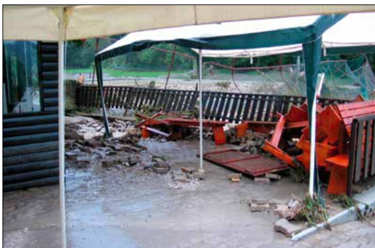
Gostinski objekt in stavba z garderobami sta bila poškodovana, uničeno stavbno pohištvo in oprema ter zaloge.
