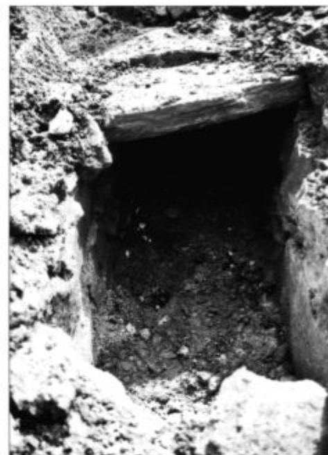
Kanal za odvodnjavanje (foto: Janez Rupnik).
