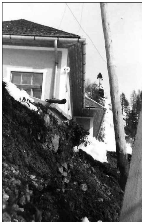
Pred šolo se je porušil oporni zid. Vir: Matevž Kopač.
