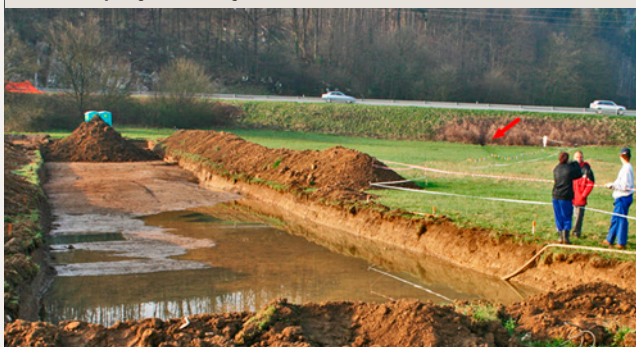
12 Pogled na prepust meteorne vode pod hitro cesto (rdeča puščica); teren pod ježo terase je zalit z vodo.
