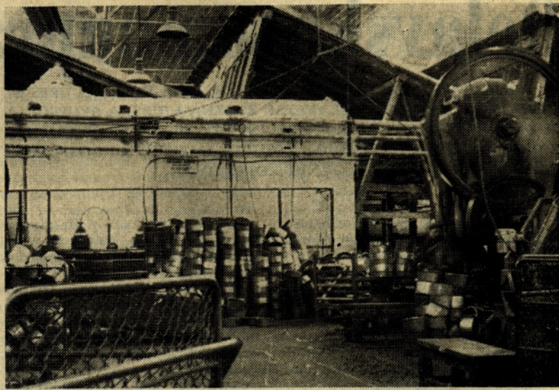
OBUDIMO SPOMIN na dni med rekonstrukcijo. Podirali smo zidove, rušili strehe, prestavljali stroje. Vendar vse to ni niti v tistih dneh zavrlo proizvodnje. Nasprotno — ljudje, ki so v prostem času rekonstruirali podjetje, so med delovnim časom presejali plan. (Foto LT)
