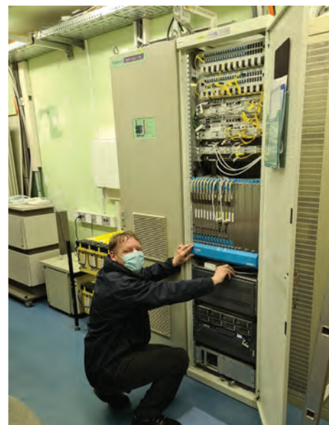
Božidar Jazbec iz TK Zidani Most skrbi in nadzira delovanje telefonskih povezav in neoviranega video nadzora 24 ur na dan.
