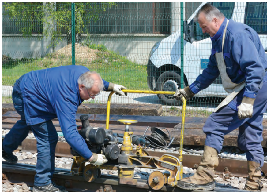
Sandi Stegne, Rudi Motore in Silvo Rimc iz SGD Sevnica s svojo ekipo skrbijo za zgornji stroj proge in tirne naprave.
