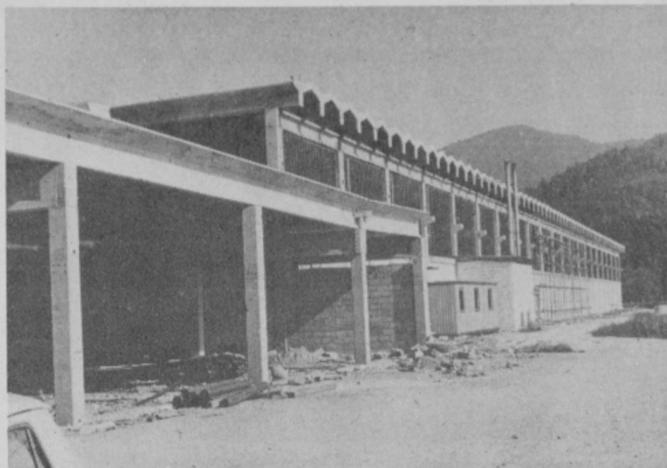
Začetek gradnje nove proizvodne hale pri TOZD Kovinarstvo na Ljubnem ob Savinji, sicer temeljne organizacije Železarne Ravne, je bil povezan s spoznanjem, da so delovni prostori postali pretesni in nadalje, da morajo v proizvodnem procesu napraviti korak naprej. Predvsem kakovostni korak na področju obdelave plemenitih jekel. In tako je na industrijskem kompleksu Ljubnega zrasla velika hala v izmeri 2340 kv. metrov, za katero bo kolektiv skupaj z opremo odštél okoli 80 milijonov dinarjev. Namenu je bodo izročili do konca 1980. leta.
