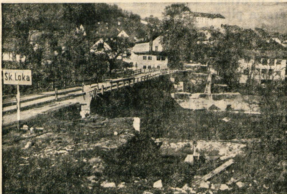
Pred štirinajstimí dnevi so delavci podjetja Tehnik iz Škofje Loke začeli graditi nov Puštalski most čez Poljansko Soro. Nov most bo dolg 36 metrov in širok 10,5 metra. Računajo, da bo zgrajen do avgusta. — Foto: F. Perdan
