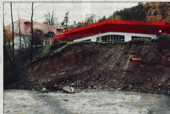
Poškodovano obrežje pri šoli v Tržiču.
