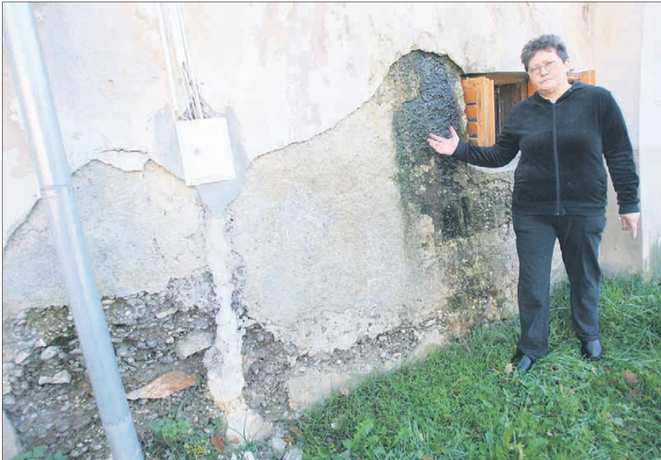
Estera Krajnc kaže na mokro, plesnivo in z algami poraslo zunanost stavbe. Znotraj nje pa črni, plesnivi in vlažni zidovi ter tla in zaudarjajoča kanalizacija.
