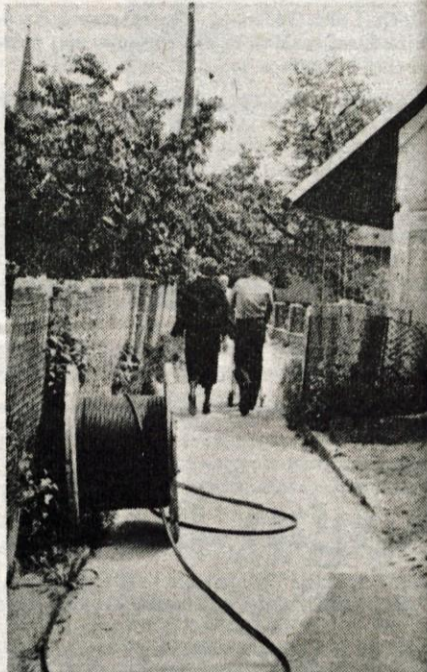
Ekipa Sreča Lapanje v teh dneh končuje izgradnjo sekundarnega omrežja v Stražišču...
