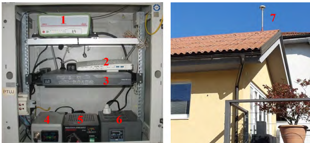
Slika 2: Primer opreme na stalno delujoči postaji: 1 – sprejemnik GNSS, 2 – modem, 3 – usmerjevalnik, 4 – baterija sprejemnika, 5 – napajalnik sprejemnika, 6 – sistem UPS, 7 – antena GNSS.
