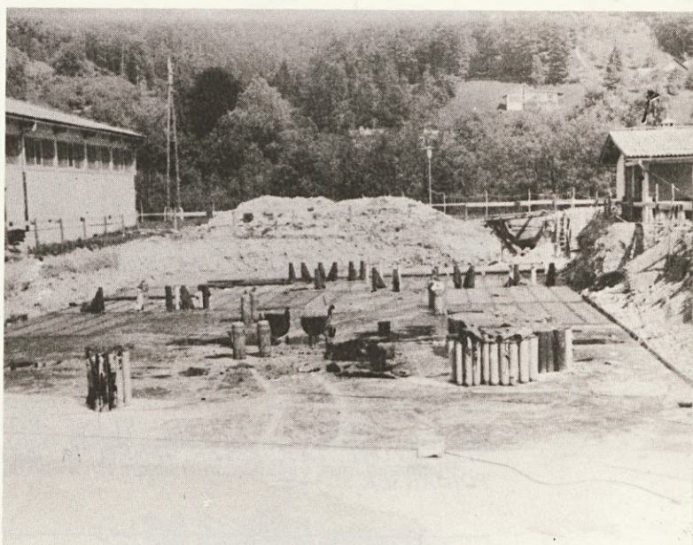
POGOSTVO DEŽEVJE JE OVIRALO TUDI POLAGANJE IZOLACIJE, KI JO IZVAJA EKIPA „INSTALACIJ“ IZ LJUBLJANE.
