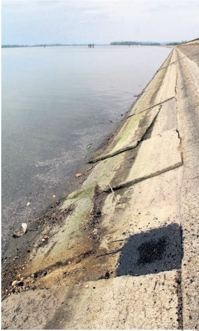
Poškodbe zgornje asfaltni plasti
