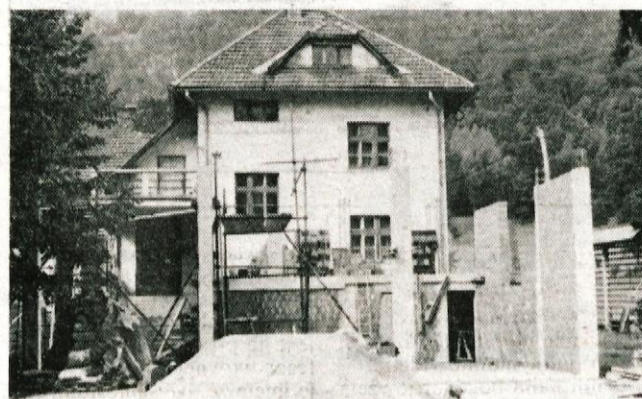
Ob stavbi šole in vrtca Dobravci s samoprispevkom gradijo gasilsko orodnišče in večnamenske prostore.... - Foto: D. Sedej
