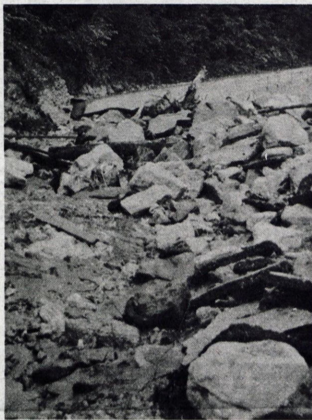
Od ceste v Davčo ponekod ni ostalo ničesar. Namesto ceste je zdaj le hudourniško krito.
