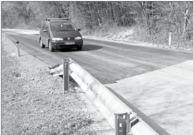
Poškodovana cesta na regionalni cesti v Ljubiji je od 6. aprila strokovno sanirana. (Foto: Jože Miklavc)
