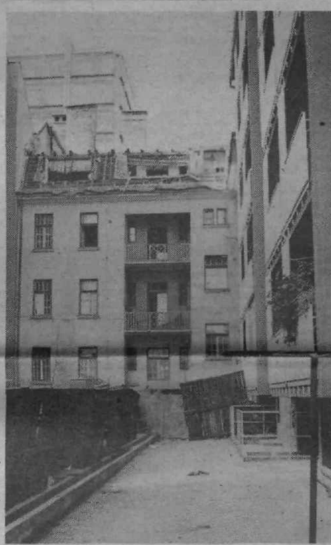
STARA POŠTA SE UMIKA - Stavbe ob Titovi cesti, kjer je bila nekoč bežigrajska pošta in postaja milice, kmalu ne bo več. Miličniki so se preselili v novo zgradbo, tudi Lenina ima nove poslovne prostore in tako bo delček Bežigrada ostal le še na fotografijah. Staro se umika novemu...
